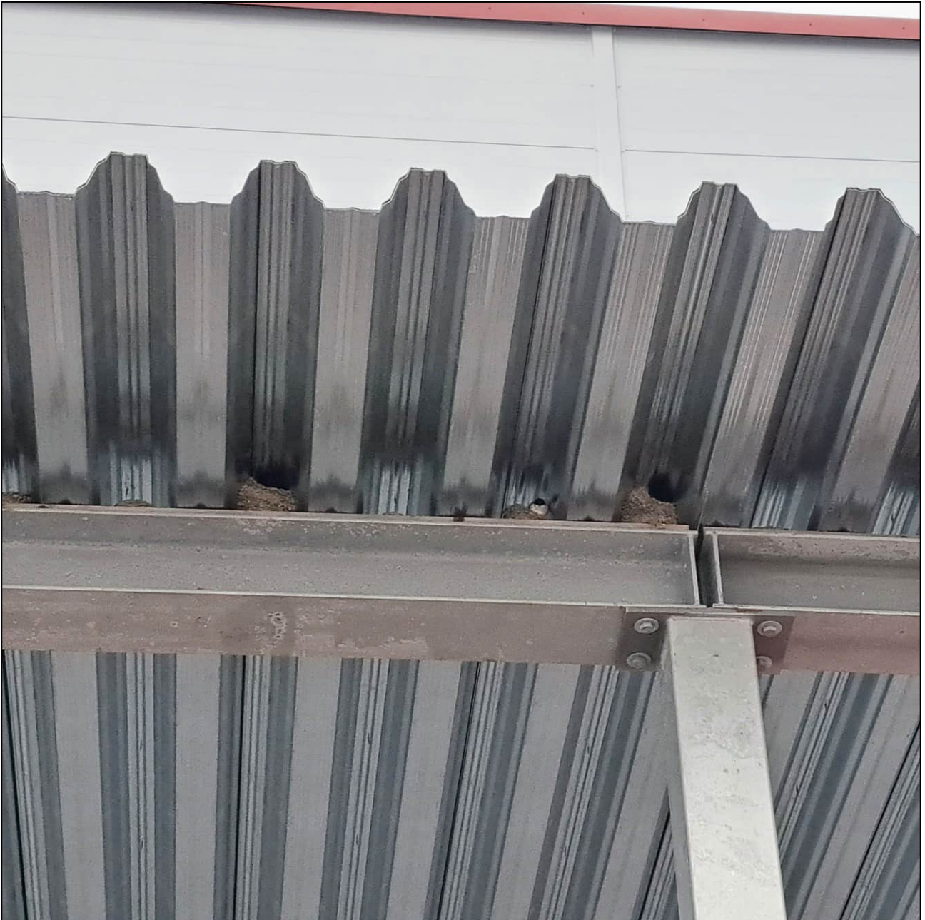
Kuva 52. Räystäspääskyn pesiä kohteella 4.2 katoksen tukipalkin päällä.
