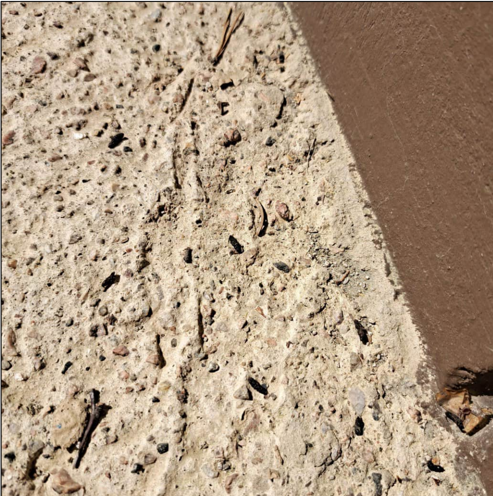
Kuva 75. Vanhan työterveystalon eteläseinustan luhtikäytävän lattialta seinän vierestä läheltä toisiaan löytyi hiukan yli 15 lepakon papanaa.
